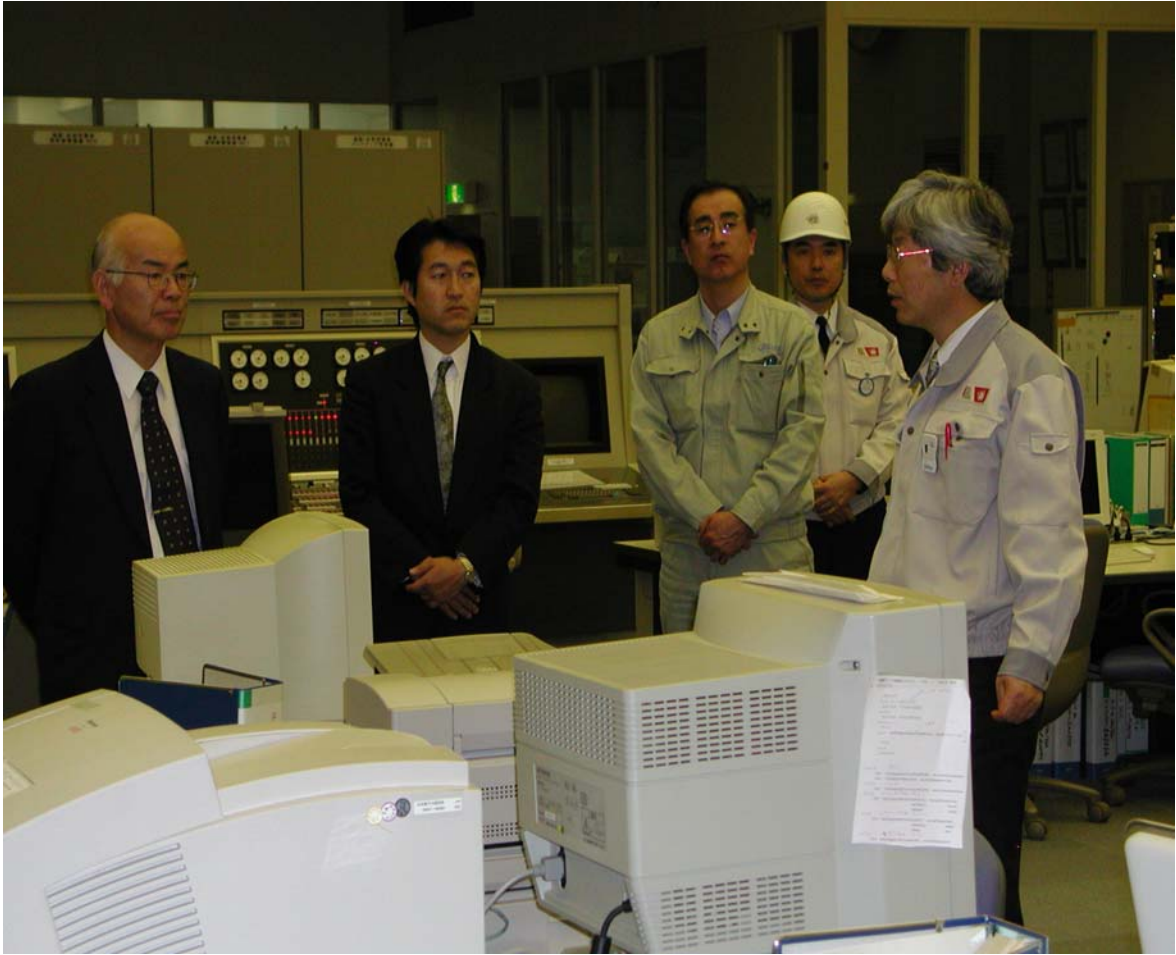
J T - 6 0 制御室において説明を受ける点 検協力実施者
