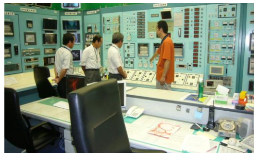
炉制御室で、施設の管理者から説明を受ける点検協力実施者
