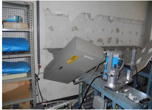
東日本大震災で壁から落下した電源ボックス
