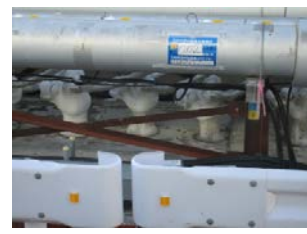
陸側凍土遮水壁設備
