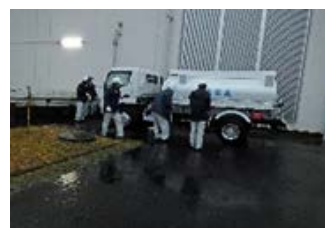
非常用発電機への給油
