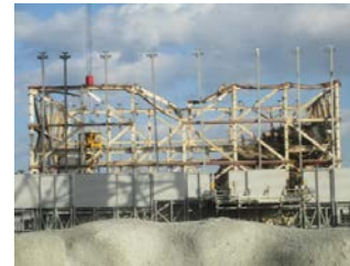
ガレキ撤去中の 1号機
